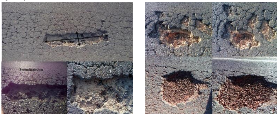
Figuras 1a e 1b: MG-146 Trinca Interligada tipo “couro de jacaré” e Panela
