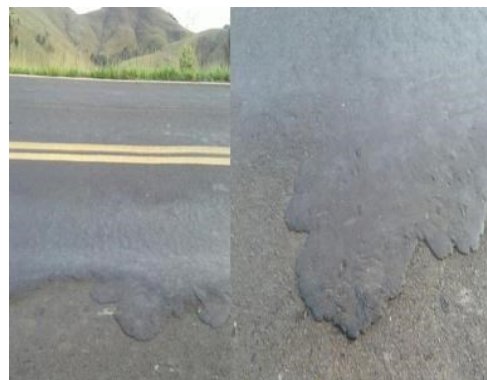
Figura 2b: Escorregamento MG-428
