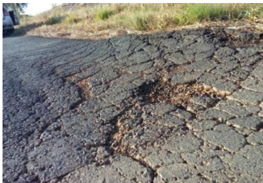
Figura 6: afundamento local, trinca interligada tipo “couro de jacaré” e escorregamento MG-146
